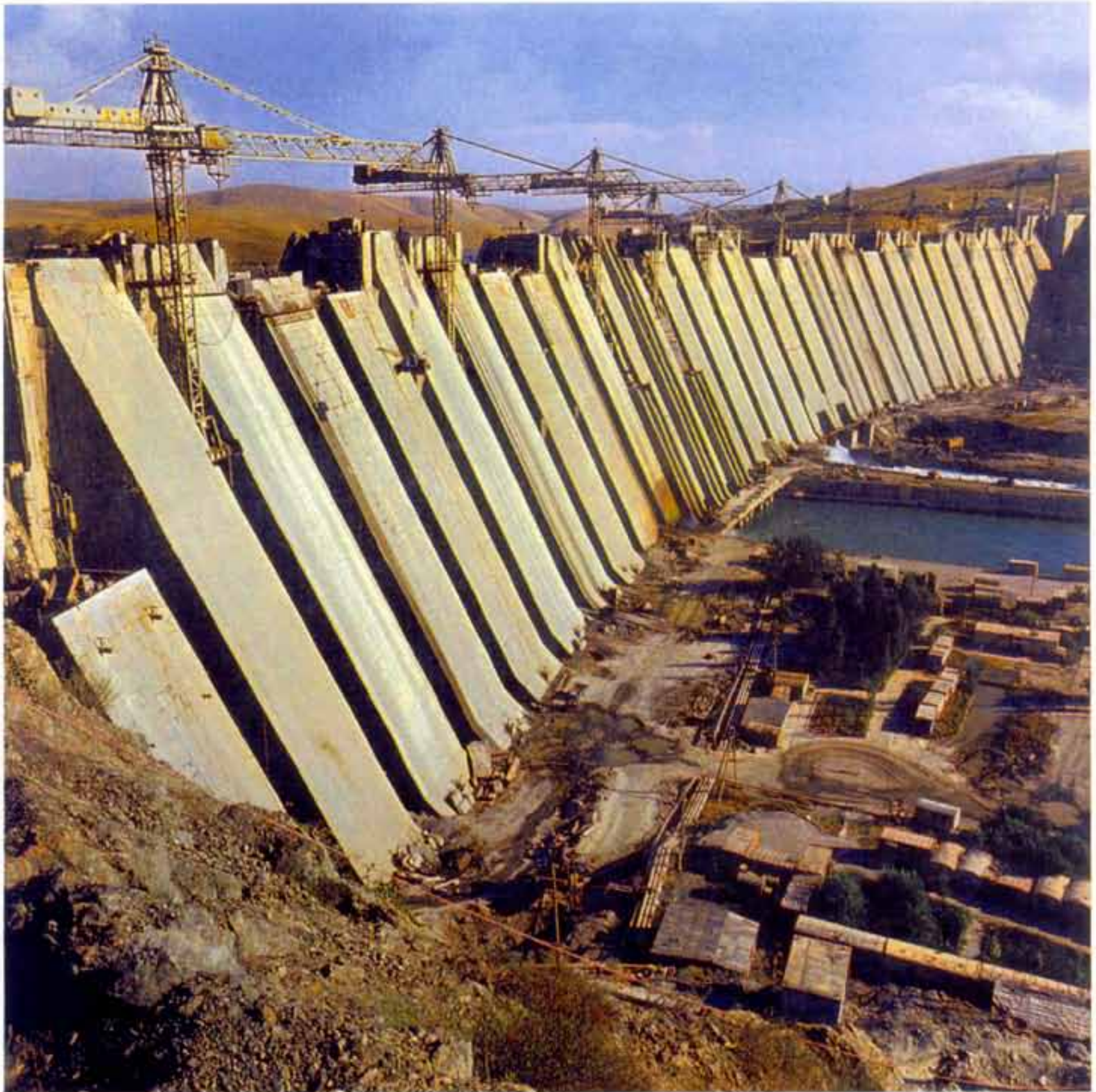
Строительство плотины на реке Карадарья высотой 115 м (Узбекистан) Construction of Dam 115 m high on the Karadarya River in Uzbekistan
